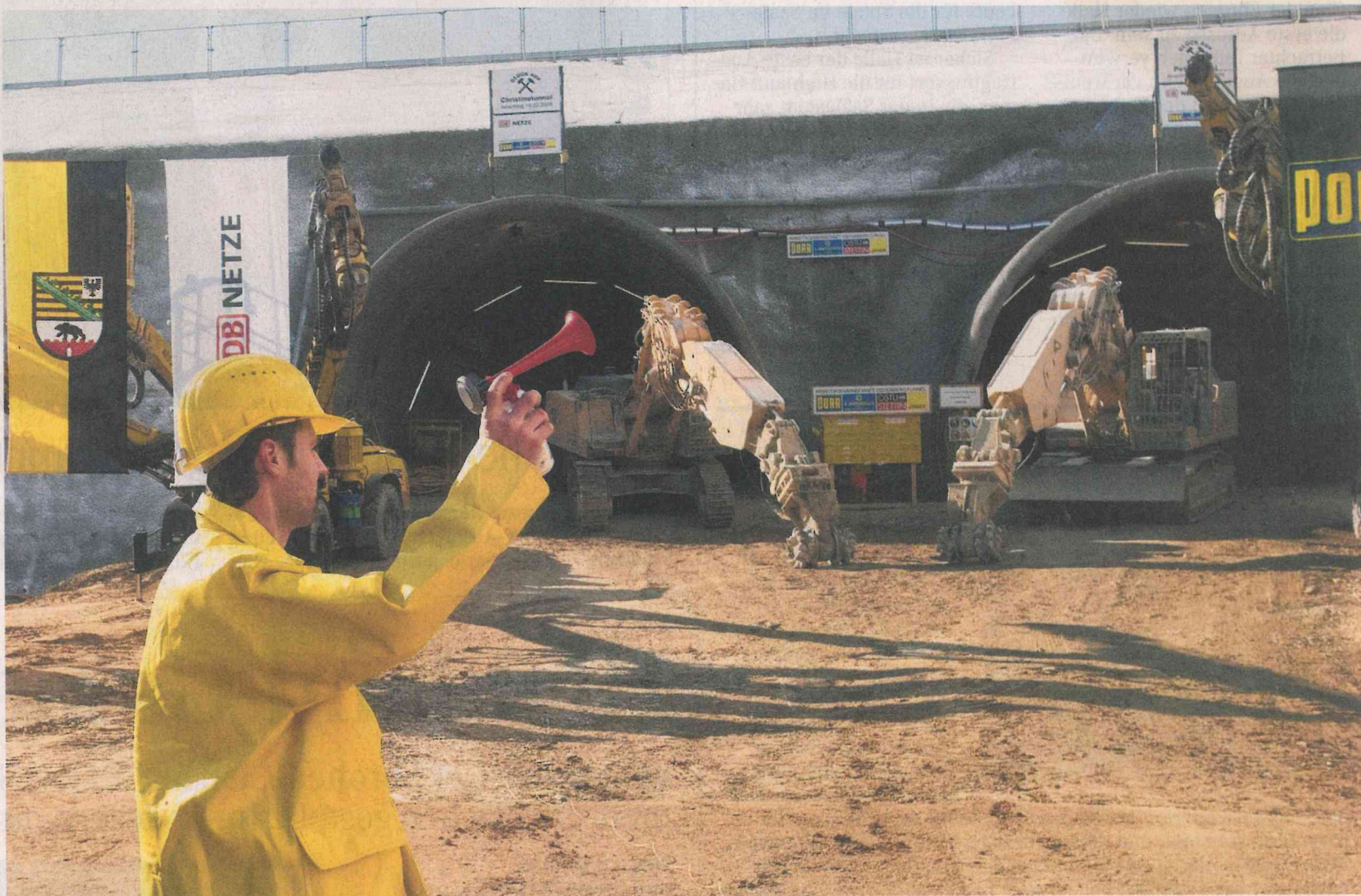
Kurz vor der Sprengung wird ein Warnsignal vom Sprengmeister am Osterbergtunnel abgesetzt.
